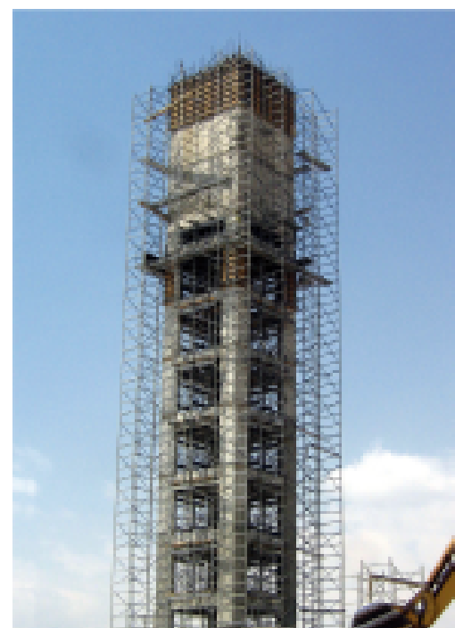
Tanque de Tormentas, Calimaya, Edo. de México.
