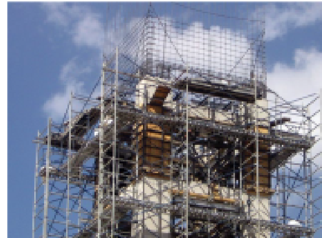
Tanque de Tormentas, Calimaya, Edo. de México.
